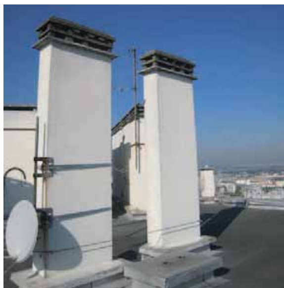
Conduits de ventilation naturelle
