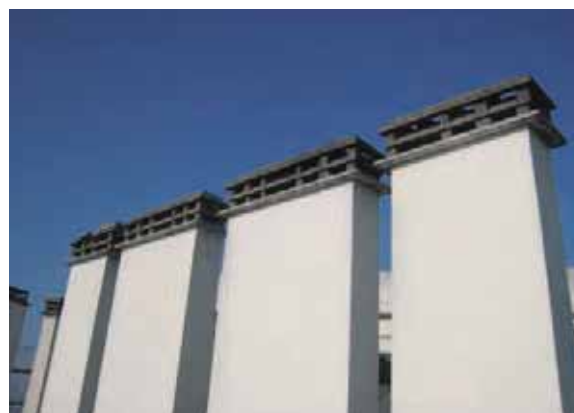
Conduits de ventilation naturelle
