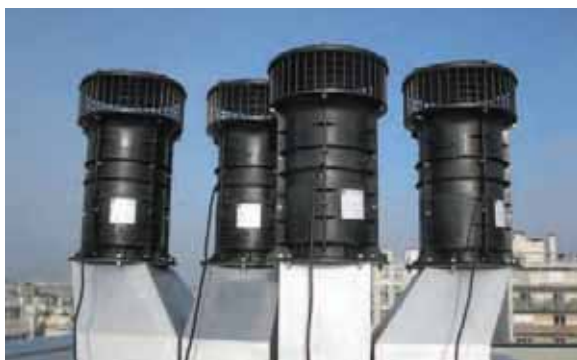
Conduits de ventilation naturelle assistée
